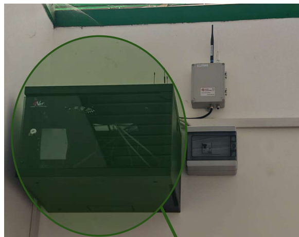
Server – Centrale di Controllo
